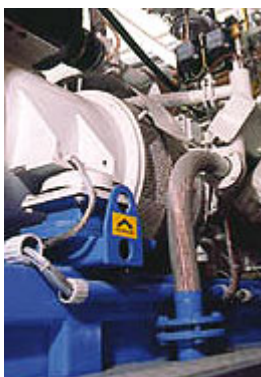
Abb. 2/3: BHKW-Aggregat im BHKW Hackenberg
